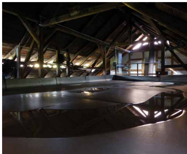
Le grand bac de refroidissement de bière, installé en-dessous du toit de la brasserie.
