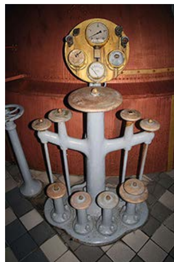
La station de commande originale des cuves se trouve toujours sur place. Est-ce qu'elle partira avec les vieux fers ?
