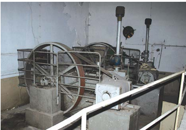
La petite salle des machines dans la tour contient encore deux moteurs âgés d'au moins 70 ans. Ce serait un sacrilège de les mettre à la benne ...
