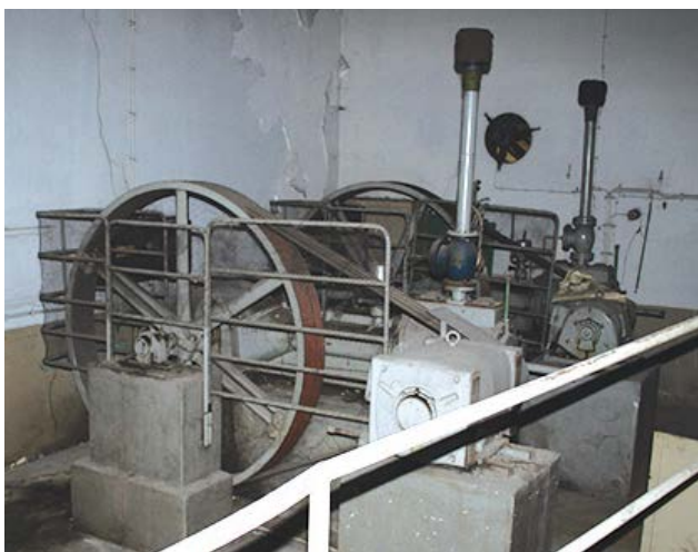
In dem kleinen Maschinenraum des Turms befinden sich noch zwei 70 Jahre alte Motoren. Es wäre eine Schande, diese einfach zu verschrotten...
