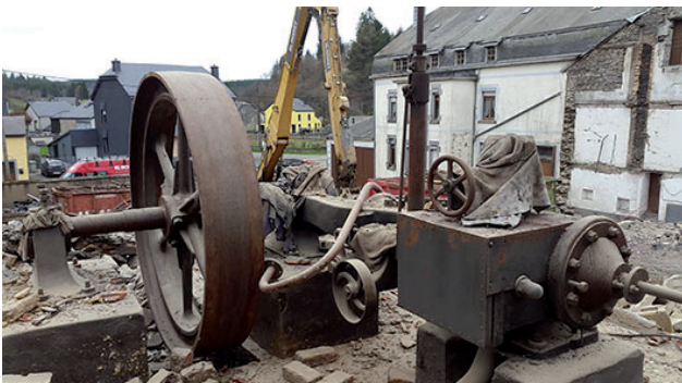
Die Dampfmaschine nach Abriss des Gebäudes. Das aufgebaute Schutzgerüst wurde bereits entfernt. Die Säcke, die vor dem Staub schützen sollten, sind noch teilweise zu sehen.
