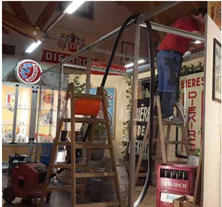
Die neue Beleuchtung wurde auch in der großen Vitrine in der Mitte des Raumes angebracht, die bisher nicht über eine eigene Beleuchtung verfügte.
