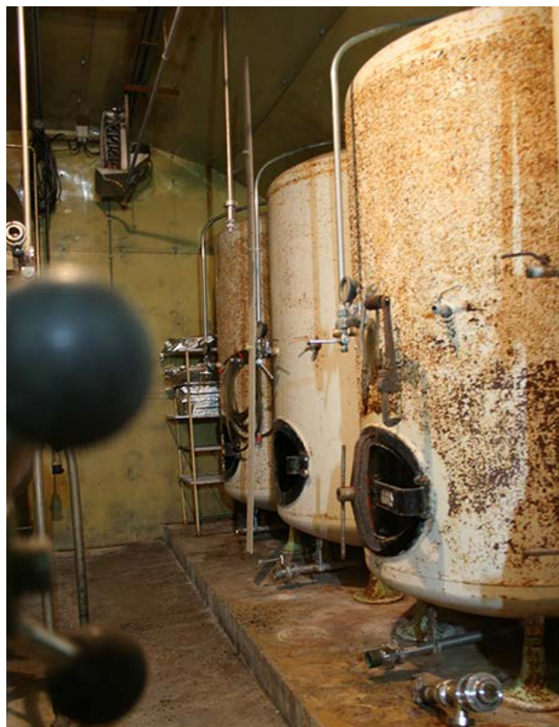
Die alten Lagerstanks aus Emallit im ersten Zwischenstockwerk des Kellers.
